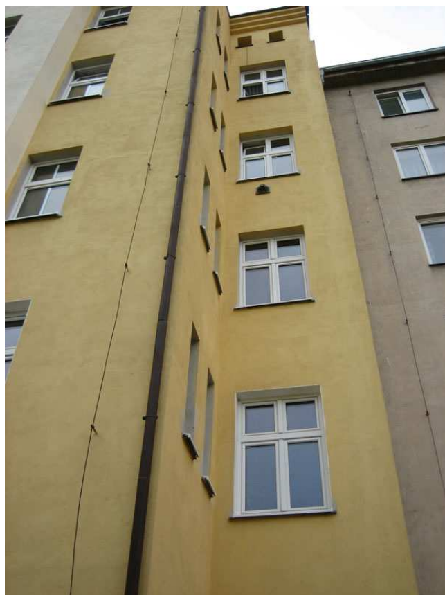
Pohled na problematickou část
