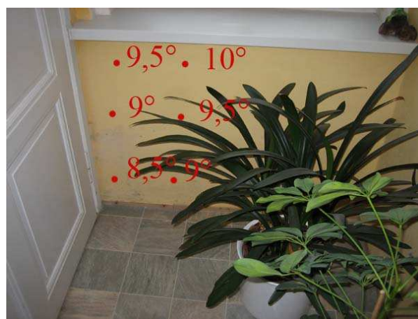
Tepelný most pod oknem na chodbě
