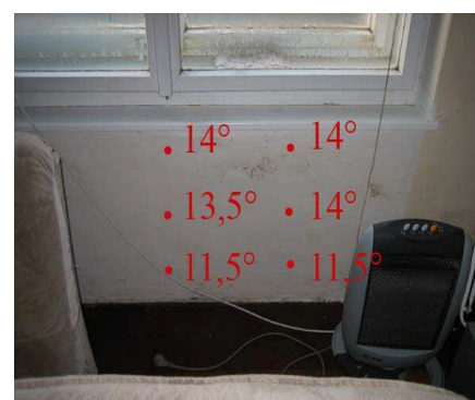
Tepelný most pod oknem
